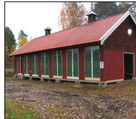
Idag är väggarna raka igen och taket nylagt på den ena sidan samt några av dörrar på plats.
